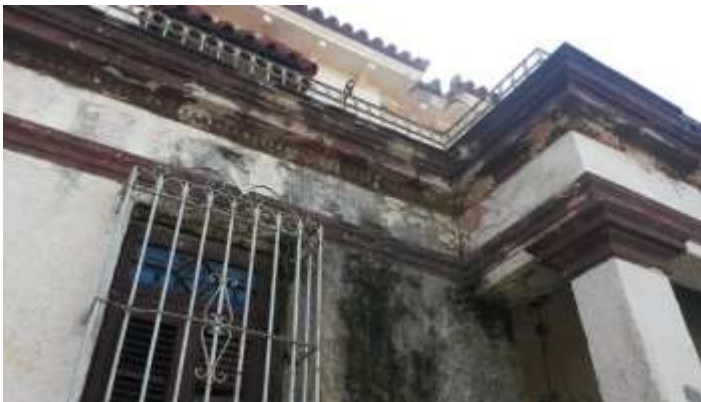
Al frente del Chalet la humedad se a infestado en la contrucción de la histórica casa.
