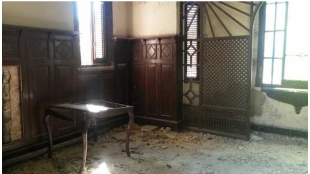
Un salón con las ventanas abiertas, es el abandono del que fue el Chalet de José L Piedra.
