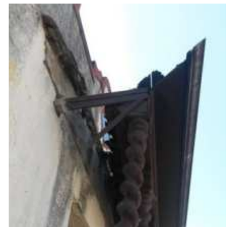
Aquí se puede apreciar el total abandono del antiguo restaurante el Pavito la cornisa de unos de sus balcones desprendida del chalet.
